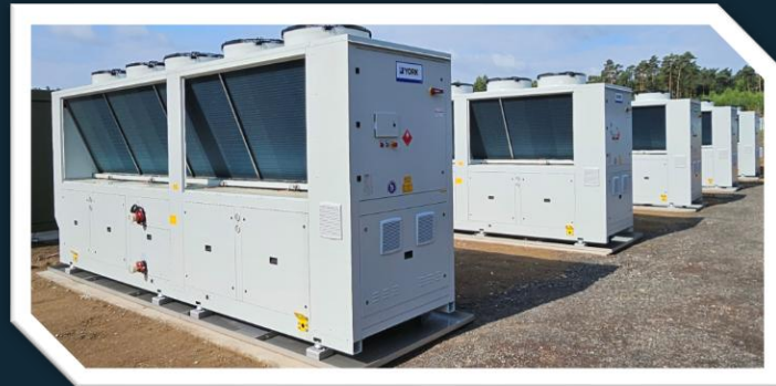
Luft-Wasser- Wärmepumpe 5 x 218 kW
