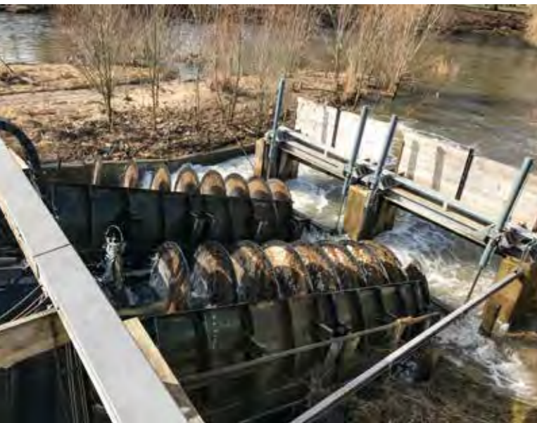
Wasserkraftwerk Blumer Wehr in Hannoversch Münden: Wasserkraftschnecken stellen heutzutage nur noch eine geringe Gefährdung für Fische und andere Wasserlebewesen dar, die die Schnecke flussabwärts passieren.
